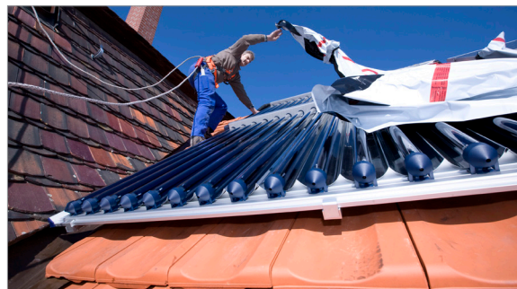
Figura 62. Ejemplo instalacion tubos de vacío
